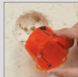
Pénétration limitée des matériaux de scellement
