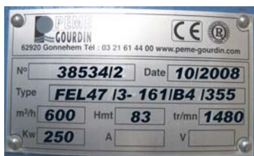
Plaque signalétique de la pompe du forage
